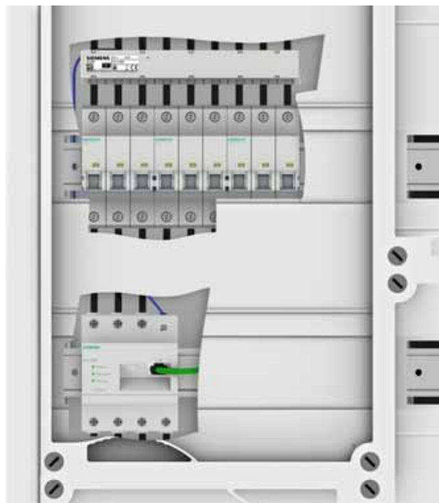
Установленная многоканальная система измерения тока 7KT PAC1200
