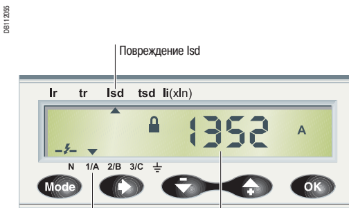
Индикация тока повреждения
