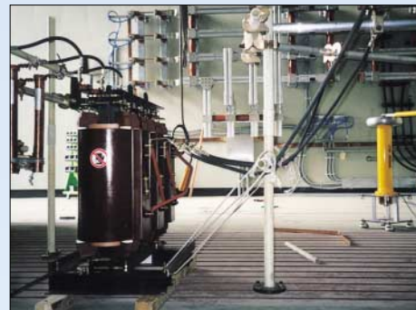
Испытание на короткое замыкание
