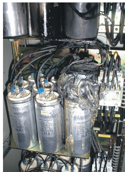
Рис.: Поврежденные высшими гармониками конденсаторы
