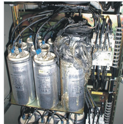
Рис. 6: Разрушенный конденсатор компенсации реактивной мощности РР: Получее высокоомное короткое замыкание на землю вызвало полное плавление конденсатора и локальный пожар
